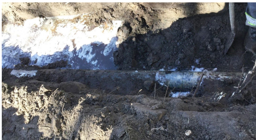
Gescheurde AC leiding als gevolg van de aanleg van een gestuurde boring.
